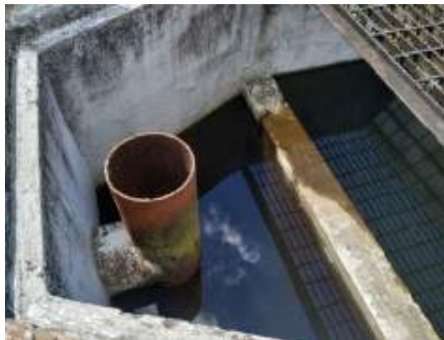
FIGURA 8.46. Trampa de aceite o separador API en una plataforma del Yacimiento Corrientes
