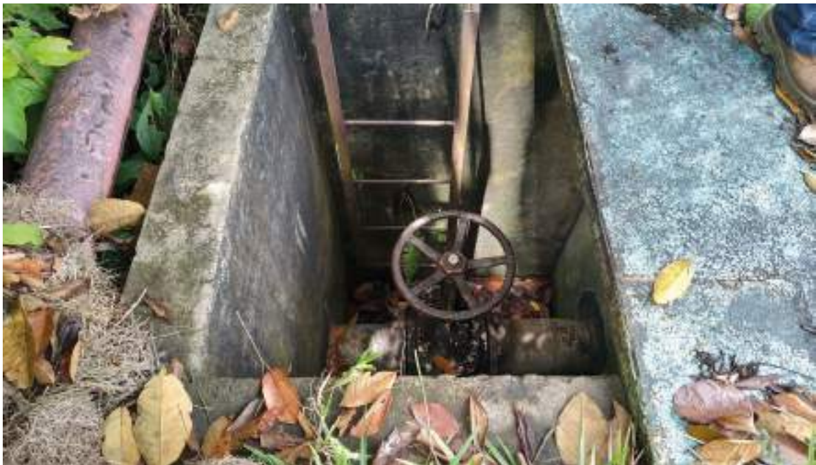
FIGURA 8.49. Válvula de control de drenaje del agua de lluvia en la fosa de tanques de la Batería 3. Yacimiento Yanayacu
