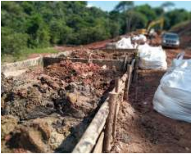
FIGURA 8.62. Suelo “contaminado” extraído para la remediación de fuga de petróleo por rotura de tubería de pozo-batería. Yacimiento Pavayacu
