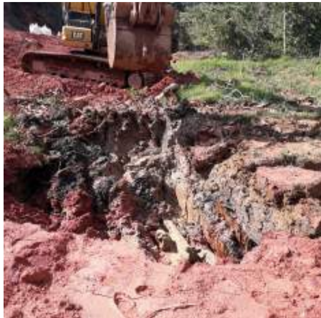
FIGURA 8.19. Prácticas de remediación inadecuadas en derrames sucedidos en la tubería que viene del pozo 35 hacia la Batería 9, en el yacimiento Pavayacu
