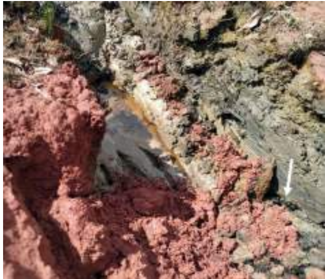
FIGURA 8.60. Afloramiento de crudo libre durante la remediación de fuga de petróleo por rotura de tubería de pozo-batería. Yacimiento Pavayacu
