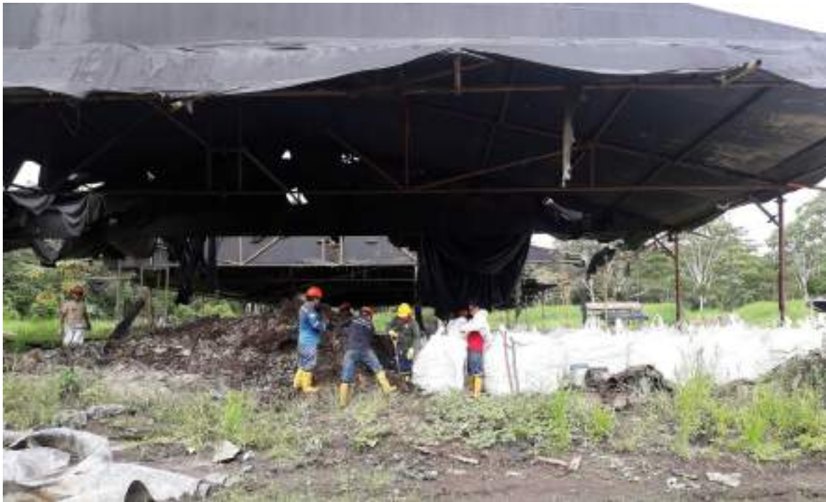
FIGURA 8.21. Sitio cercano a la plataforma 31 donde se almacena material contaminado para su posterior traslado a un sitio cerca de Iquitos, vía barcaza
