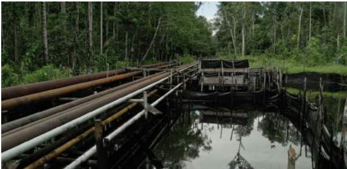
FIGURA 8.18. Derrame de hidrocarburos en las tuberías que comunican la plataforma 44 con la 12X que han producido la afectación de suelos, vegetación y fauna. El petróleo fue confinado con barreras oleofílicas para su recolección
