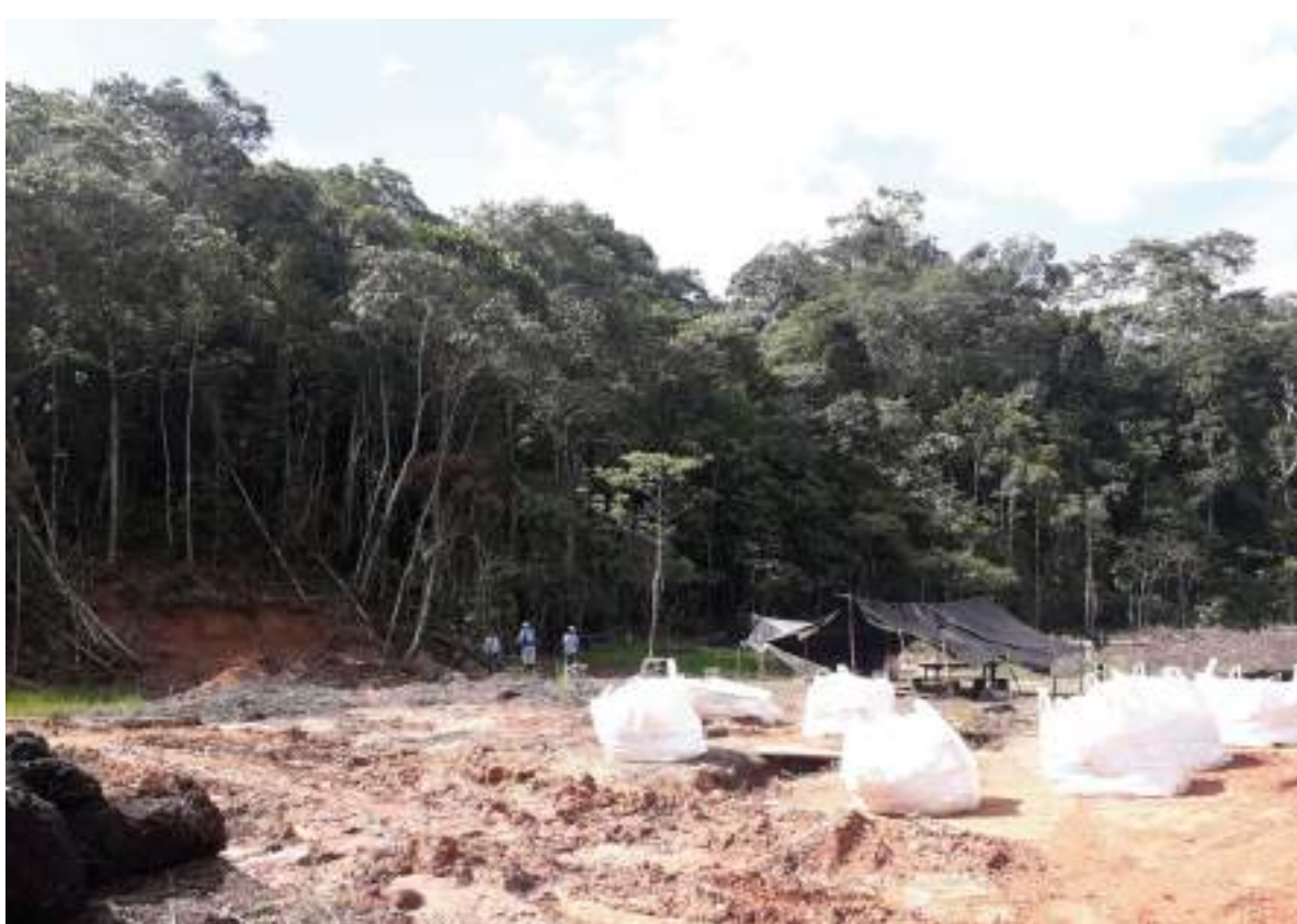
FIGURA 8.20. La intervención en la vegetación para introducir la máquina es excesiva
