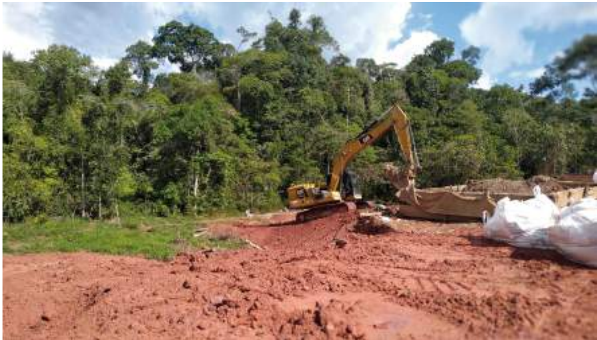
FIGURA 8.61. Movimiento de tierra para la remediación de fuga de petróleo por rotura de tubería de pozo-batería. Yacimiento Pavayacu
