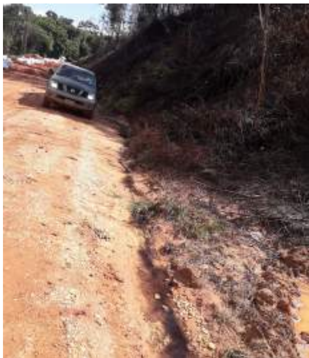
FIGURA 8.26. Zona susceptible a la erosión laminar y concentrada. Ausencia de obras de control de erosión (cunetas)
